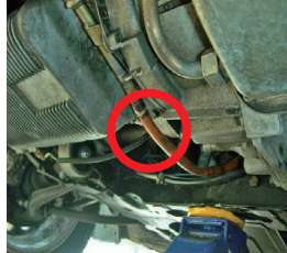
エアコン 銅管
